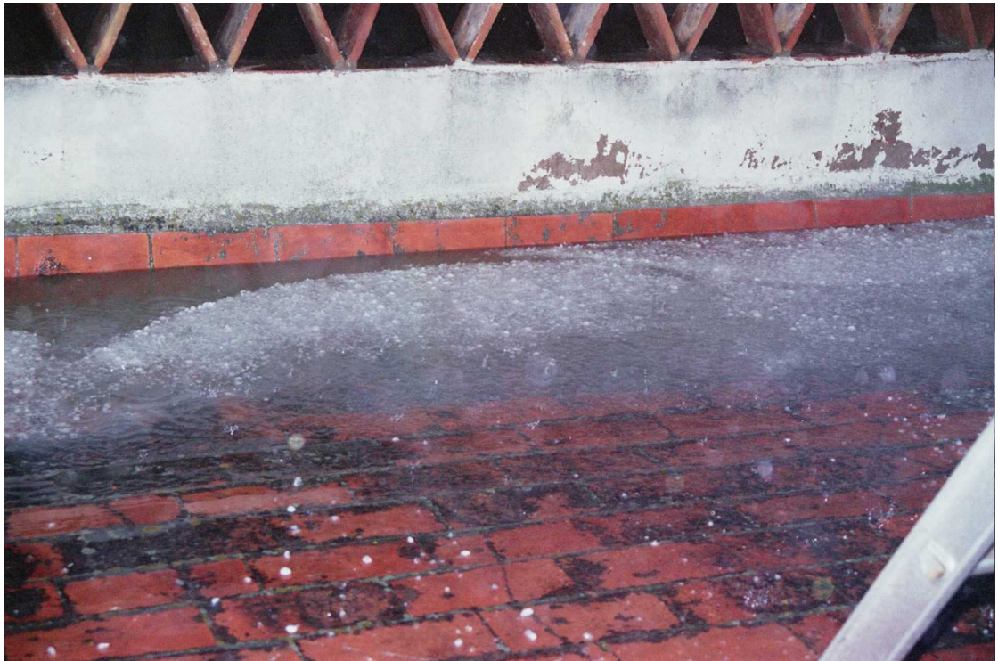
Acumulació de pedra en un terrat després de la pedregada.
